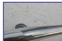
Fissures dans la couche d'enduit gélifié du pied de chandelier
