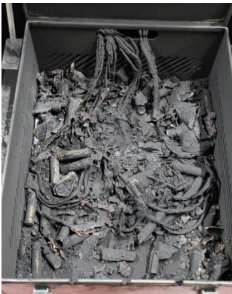
Figure 1. Les conséquences d'un incendie et d'une explosion d'une batterie de l'ensemble B2 pendant le test de surcharge T.7
