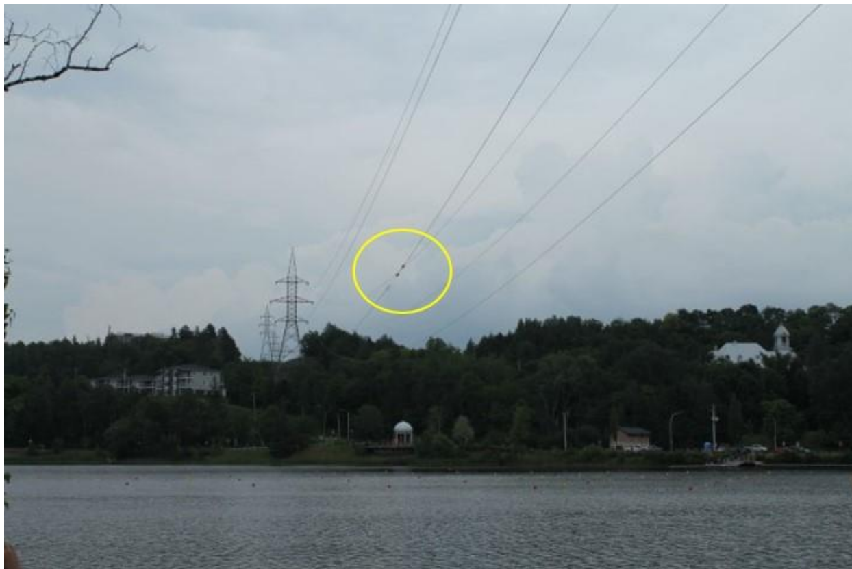
Figure 2 : Photo des dommages causés au câble inférieur de la ligne de transport d'électricité (Source : BST)
