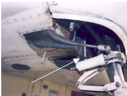
Photo 1: View of steering tube as installed Photo 1 : Vue tube d'orientation tel qu'installé
