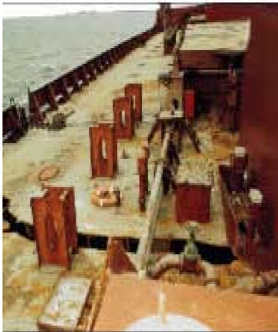
Emplacement de la fracture sur le pont principal
