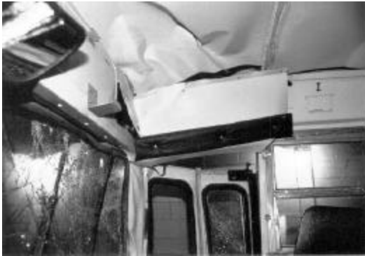
Rupture d'un joint
