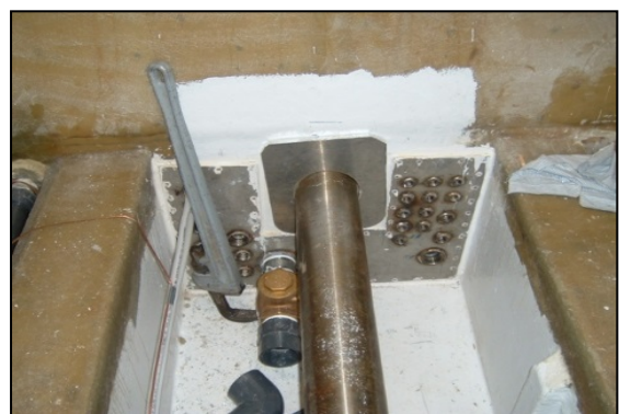
Figure 3.0 (b)(ii) : Mesures prises pour assurer l'étanchéité à l'eau des conduits traversant une cloison d'un bâtiment de pêche. (Source : collection personnelle de J.G.)
