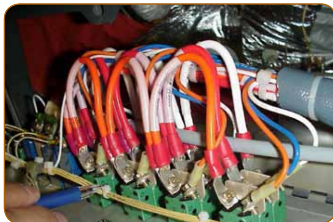
Systèmes d'interconnexion du câblage électrique (EWIS)
